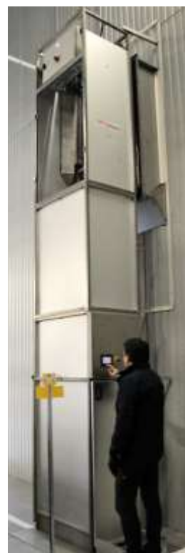
Vidatris à l'intérieur du bâtiment
